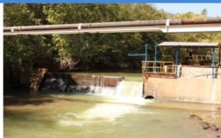
Captação do Ribeirão São Lourenço
